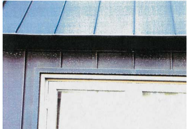
写真2 カラー鋼板製壁面の白錆発生 (日本海から約20km：4年経過)
