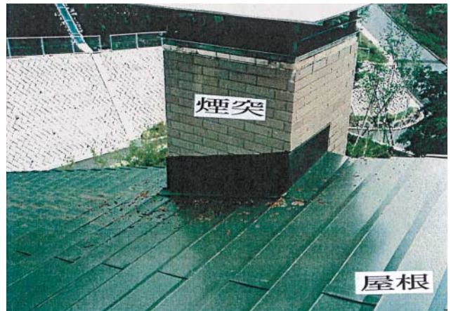
写真3 カラー鋼板製屋根面の煙突近傍の腐食 (積雪地：1冬経過)
