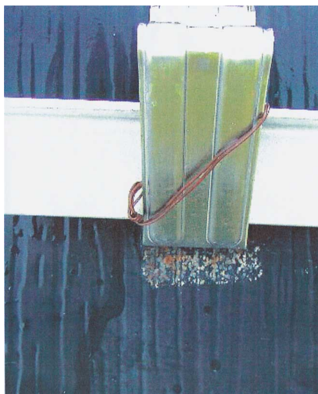
写真2 カラー鋼板屋根面の銅線による腐食例 (積雪地：2年経過)
