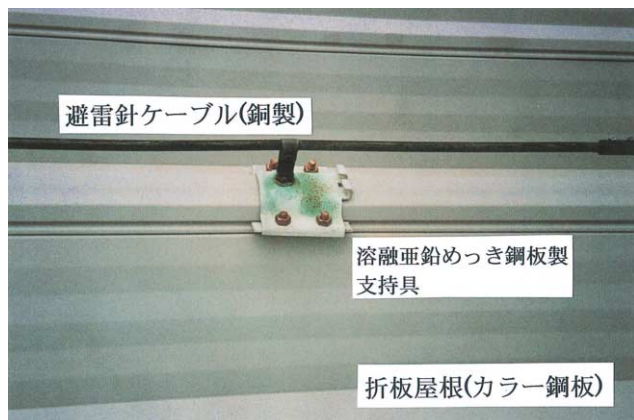
写真1 銅製ケーブル下の腐食例 (海岸・温暖地：4年経過)
