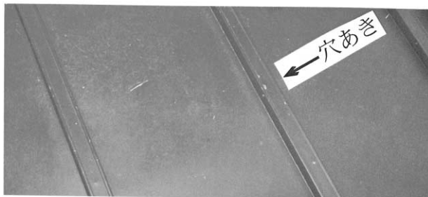
写真4 瓦葺葺屋根（心木あり）キャップ部の穴あき腐食例（一般カラー：3年経過）
