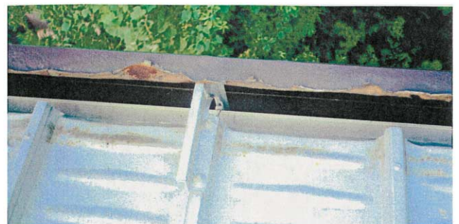
写真1 カラー鋼板の端面腐食例（12年経過）
